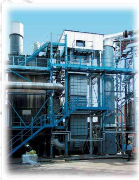
Instalacja oczyszczania gazów żeliwiakowych
